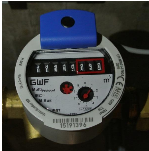
Bild 8-33: Kaltwasserzähler VarioCooking Center 211+, 06.07.2015 13:24
