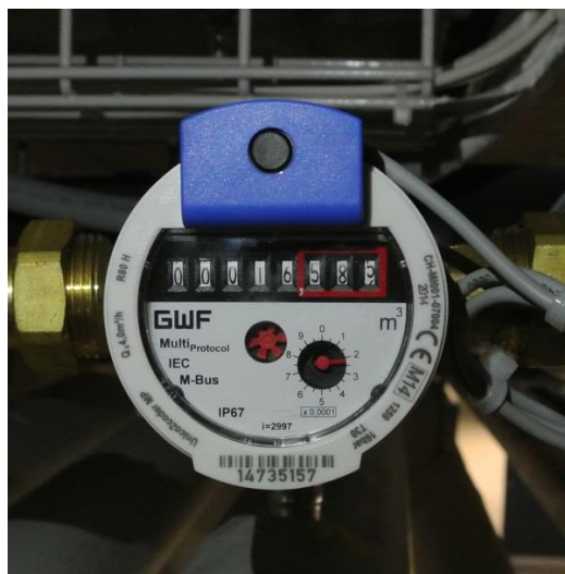
Bild 8-35: Kaltwasserzähler VarioCooking Center 112T, 06.07.2015 13:26
