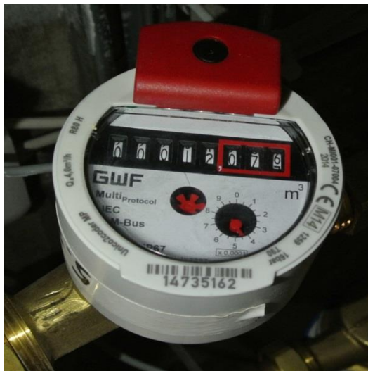
Bild 8-34: Warmwasserzähler VarioCooking Center 112T, 06.07.2015 13:25
