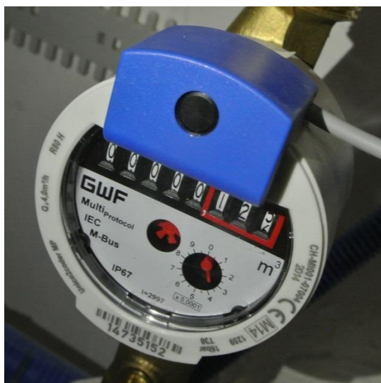
Bild 8-44: Kaltwasserzähler enthärtet Universalspüle 130.2, 06.07.2015 13:59
