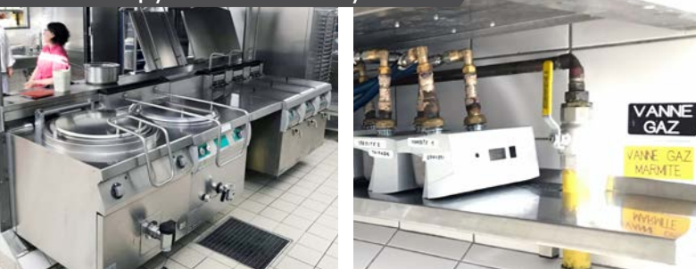
Instalace plynoměru ve školní kuchyni.
