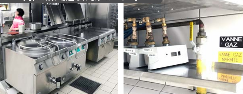
学校の厨房に設置されたガスメーター。
