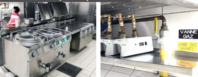
Gassmålerinstallasjon i skolekjøkkenet.
