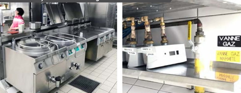
Instalação do medidor de gás na cozinha da escola.
